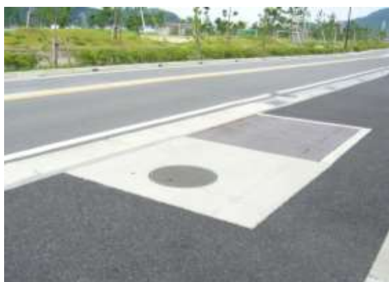
マンホールを埋め込んだ特注品
