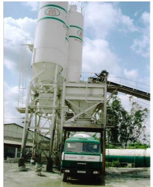
生コンプラント
