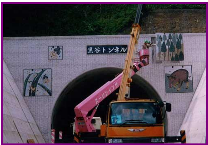
トンネル出入り口に設置
