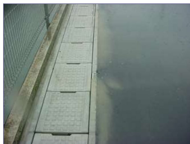
排水ドレン金具で路面の雨水を側溝内へ
