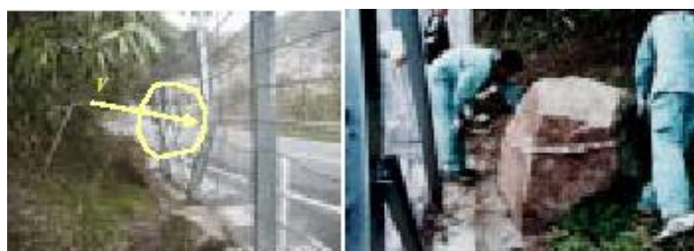
写真1 ストンガードの変形(玉谷町)
