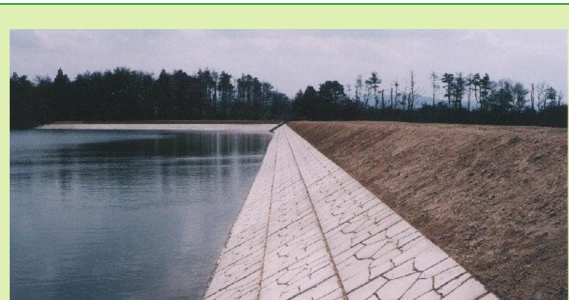
工事名：岸本町 福岡ため池 発注：米子農林振興局 現場：西伯郡 岸本町
